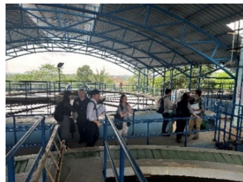
Batu Amper 浄水場
