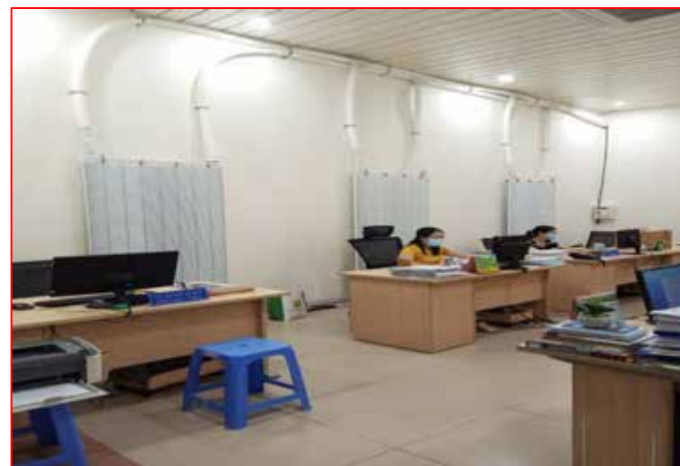
ITPC事務所に仮設した輻射式冷房装置
