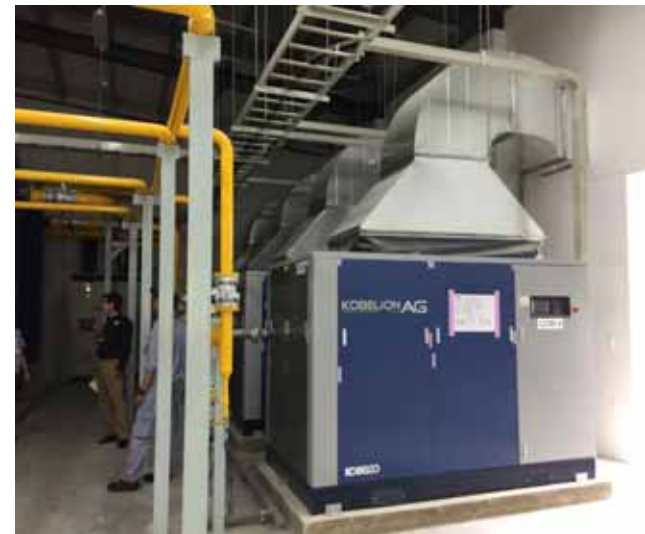
工場内 空気圧縮機設備 4
